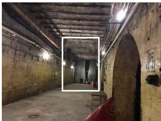
Но оказалось, что начало и конец этого коридора разделяет больше 100 лет, и передовые советские строители 1970 года смогли создать архитектурные конструкции идентичные великим А.Е.Веберу, Р.И.Клейну, настолько искусно, что очертить границу (белый контур) можно только виртуально.
